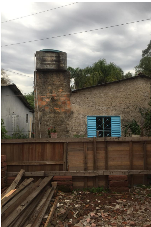
A. Armazenamento de Água Inadequado
