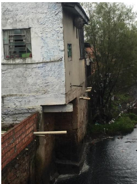
E. Solução de Esgoto Inadequada
