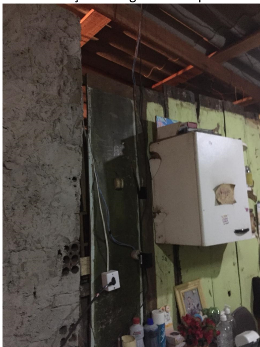
G. Instalações Elétricas Inadequadas
